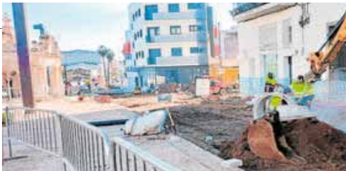
Tramo de avenida levantada frente al Hornito. J. M. R.
