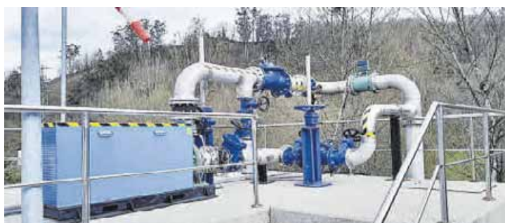
Instalación de mejora realizada por Aguas de Langreo. | Cedida a LNE
