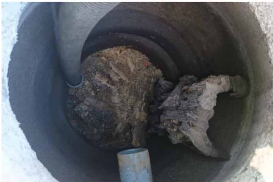
Estado de la red de saneamiento en el momento de la incidencia. DA
